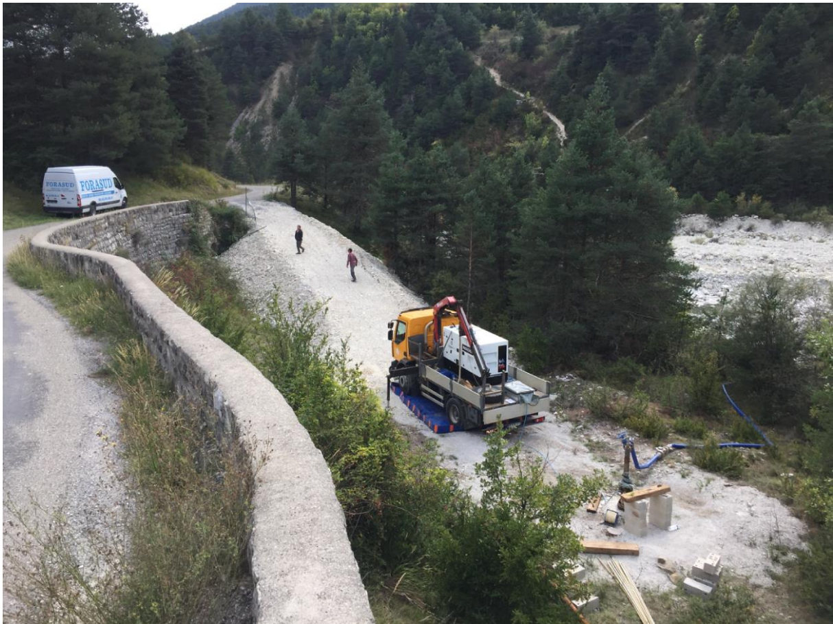
Forage du Lacet (lors des essais de pompage)
